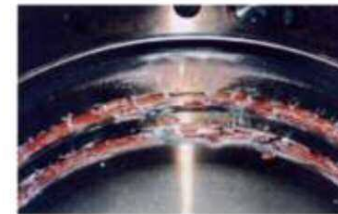
フランジガスケットの過温劣化状況
